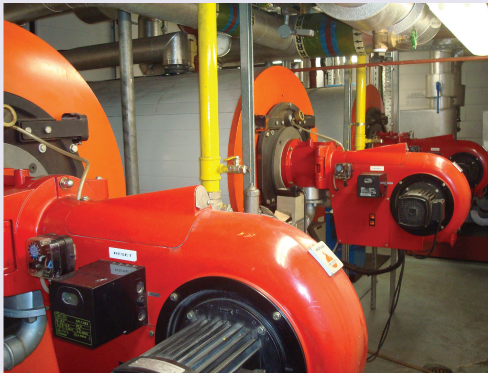
Resonantie in de pomp kan zich voortzetten in andere onderdelen van het systeem
